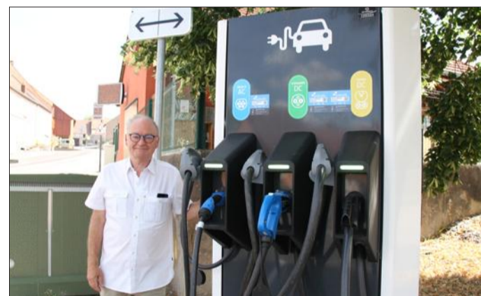
Didier Engelmann à côté de la station de recharge pour voitures électriques. Photos DNA/Thomas LEPOUTRE
